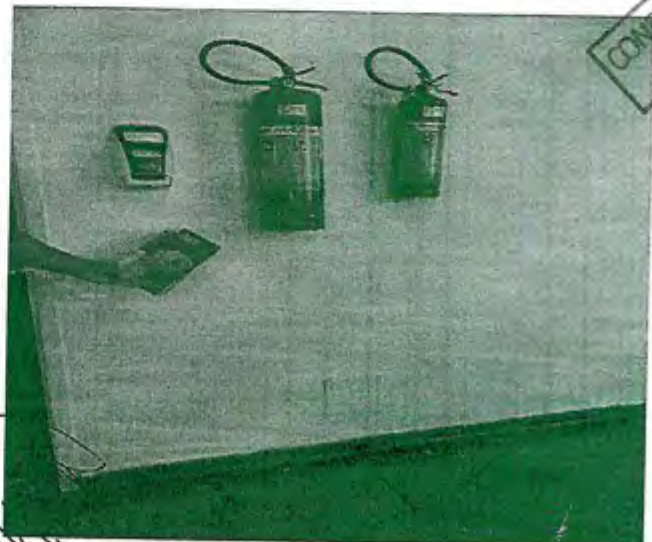
Foto 18: Extintor sem sinalização.
